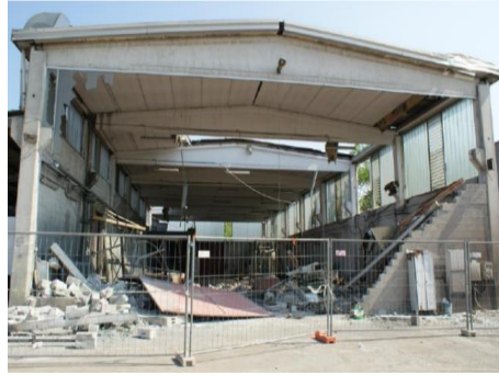
Figure 2. Example of damaged LSB building (source: Agenzia Regionale per la Ricostruzione - Sisma 2012).
